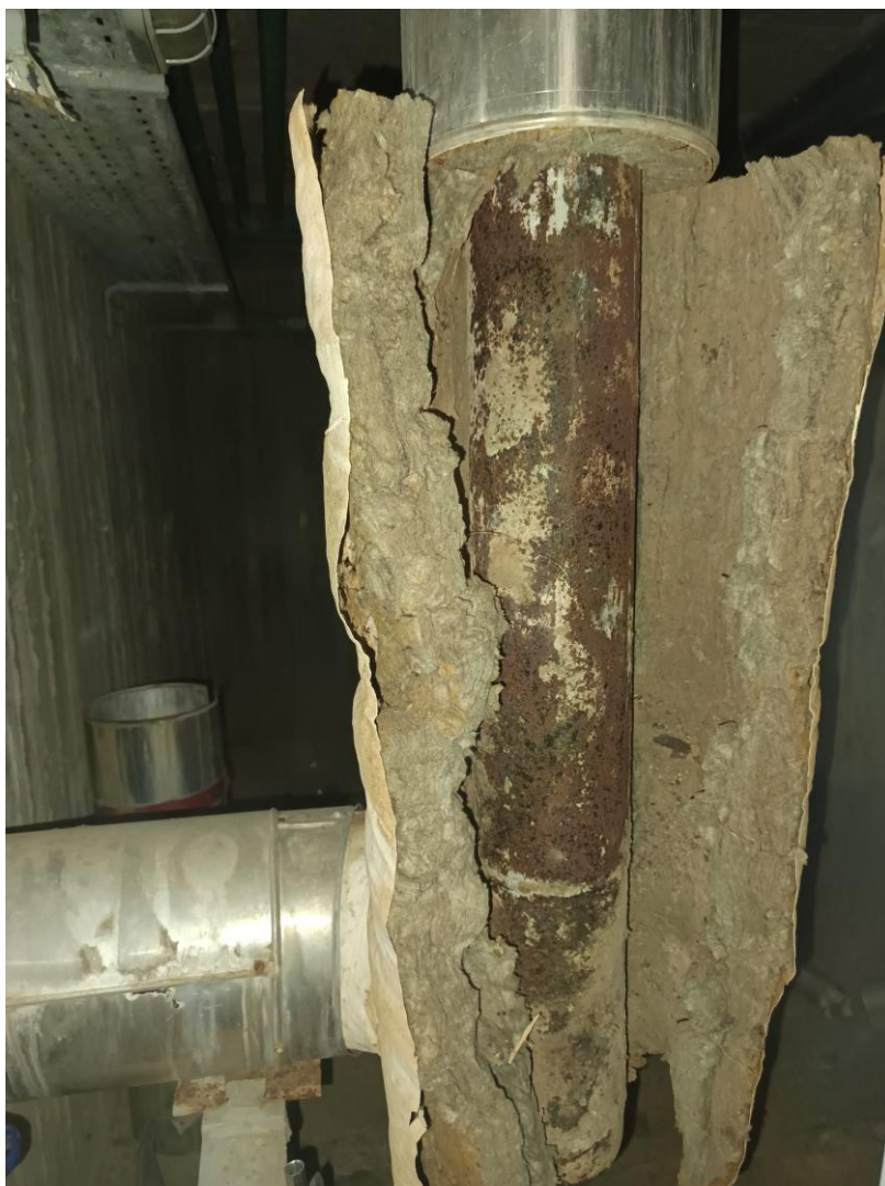
Εικόνα 1: Σωλήνας διαμέτρου 5'' στον οποίο θα τοποθετηθεί ατμοφράκτης.
